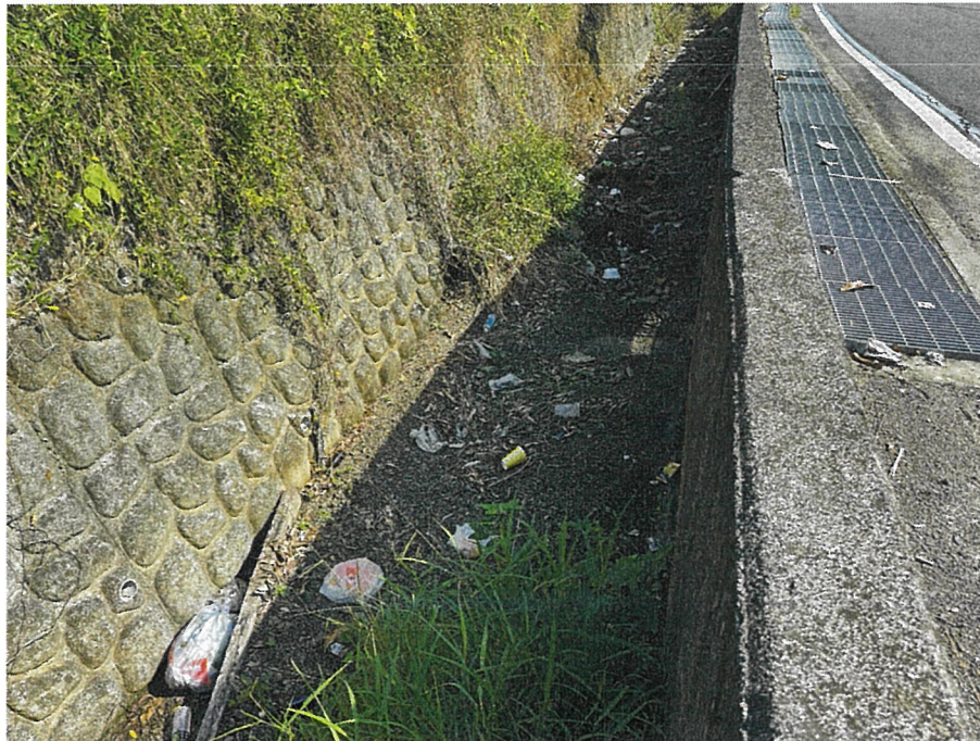
路側排水溝淤積
