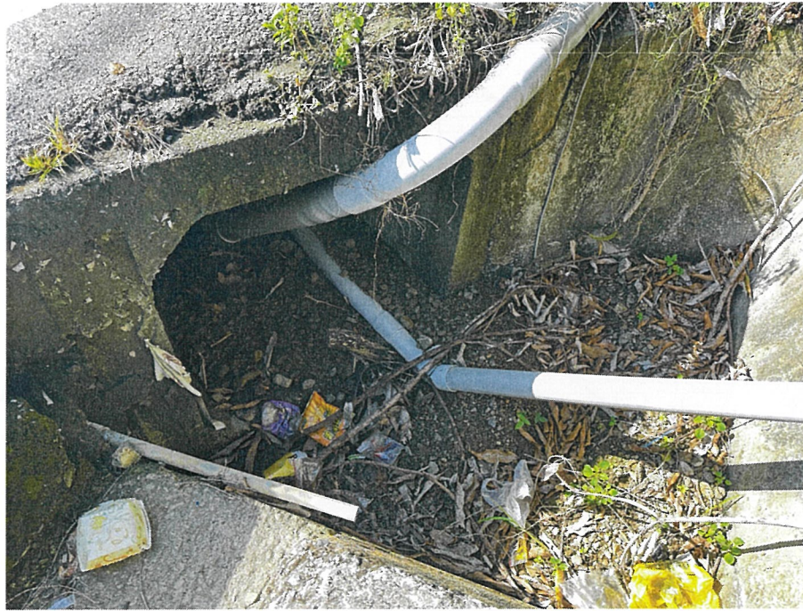
路側排水溝淤積
