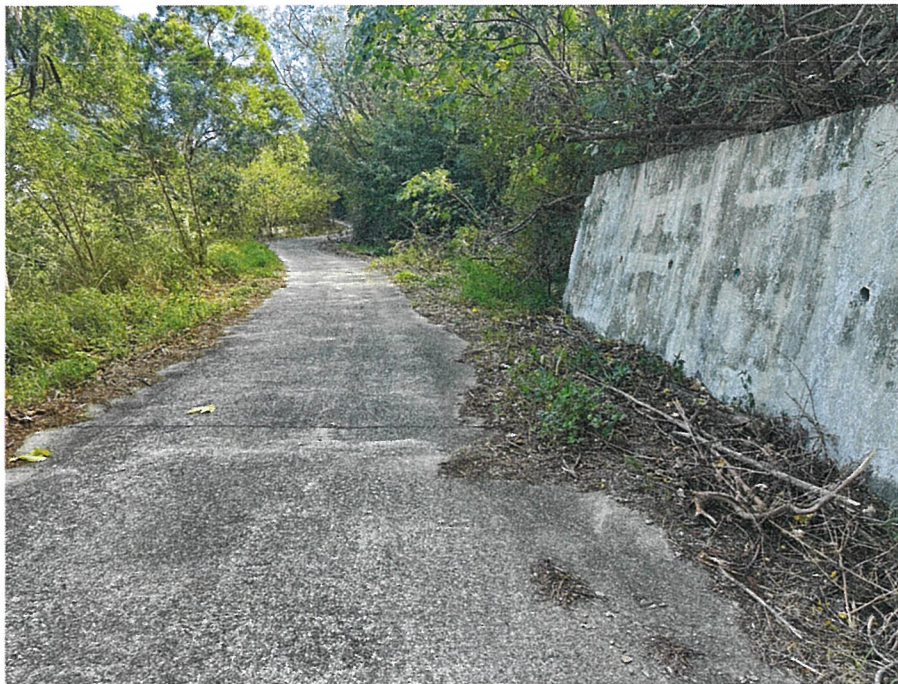
路側土石淤積及排水溝淤積
