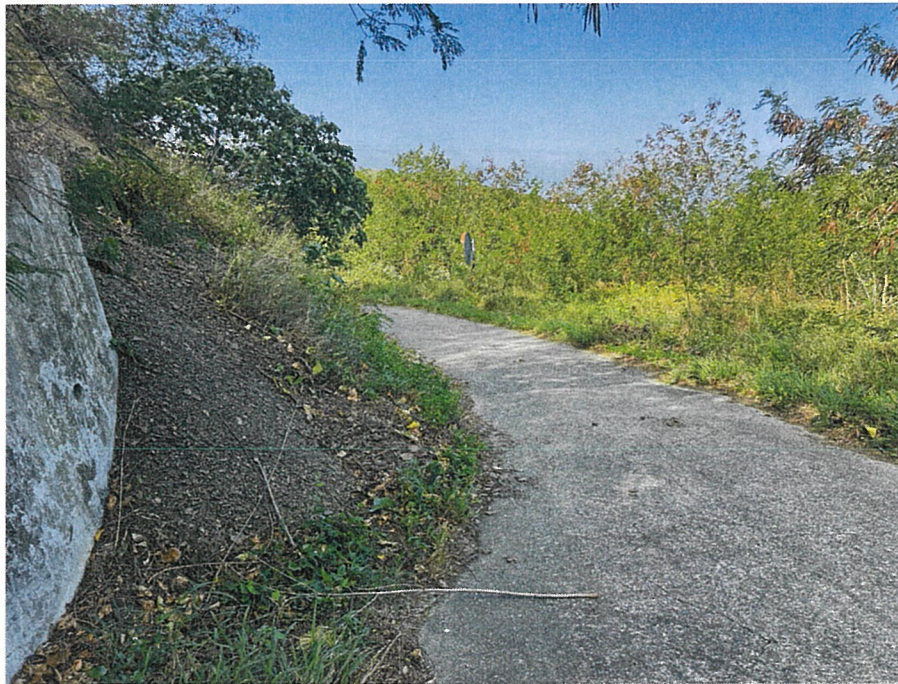
路側土石淤積及排水溝淤積
