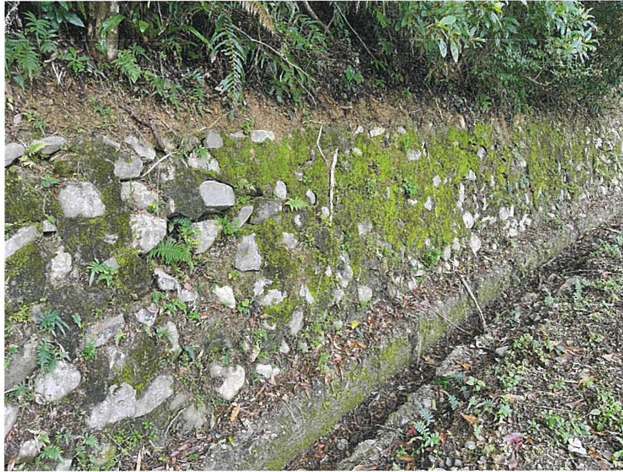
路側排水溝淤積
