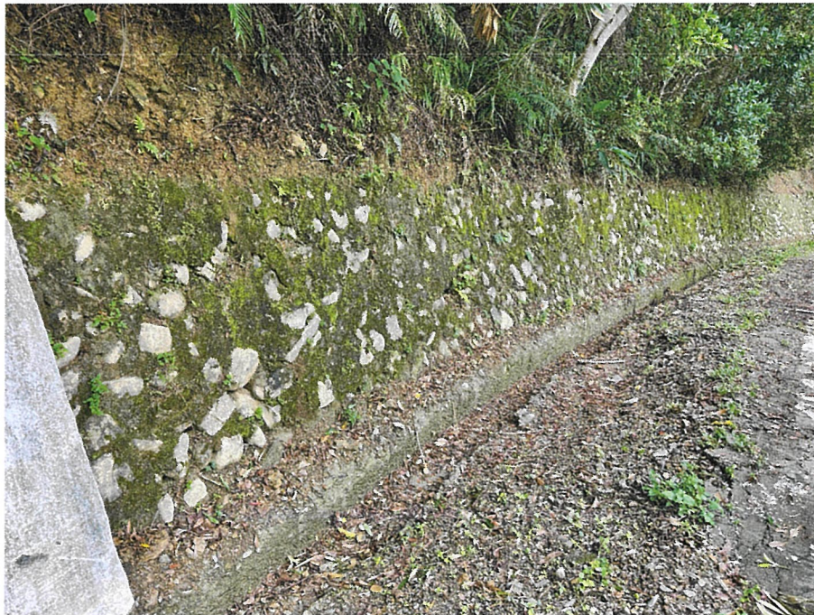
路側排水溝淤積
