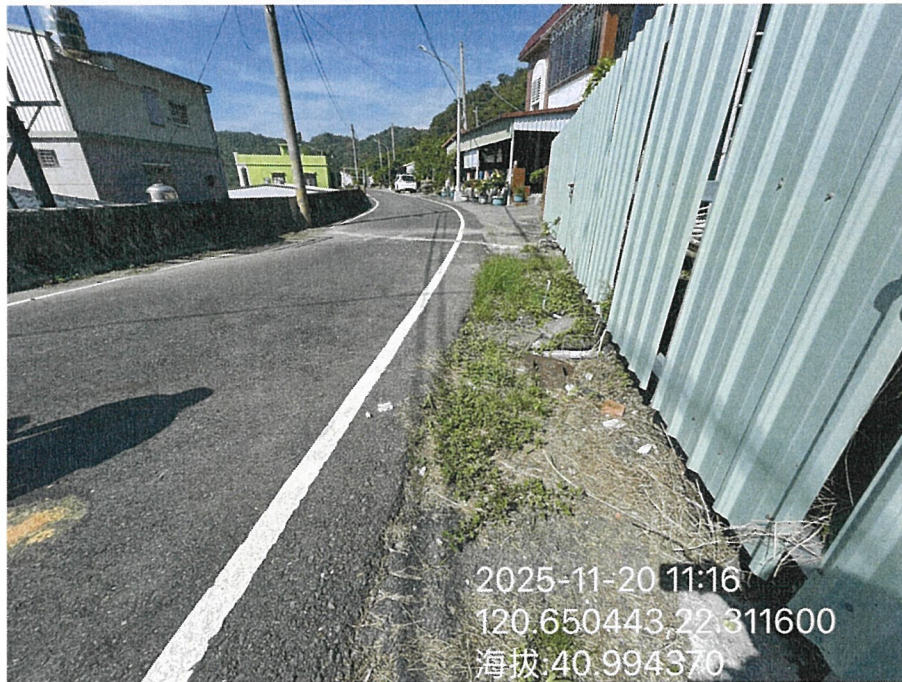
排水溝老舊損壞、路面低窪處積水
